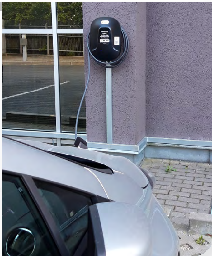
1. attēls. Jaunās uzlādes pieslēgvietas pie AS "Latvenego" ēkas Rīgā
