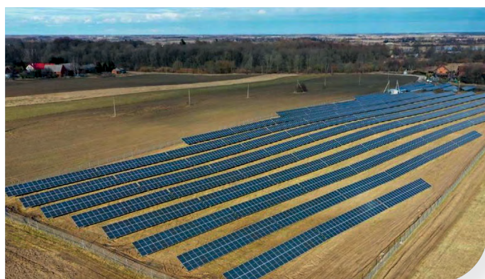
Attēls. Elektrum saules enerģijas parks Lietuvā, Klaipēdā, ar kopējo jaudu 1,5 MW, kas paredzēts elektroenerģijas ražošanai klientiem.
