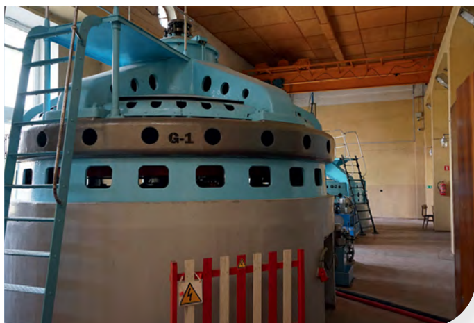
Attēls. Aiviekstes HES mašīnzāle.
