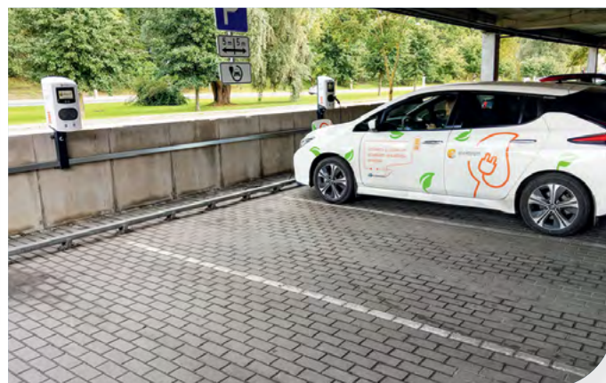
Attēlā. Elektromobiļu uzlādes pieslēgvietas tirdzniecības centrā Sky&More
