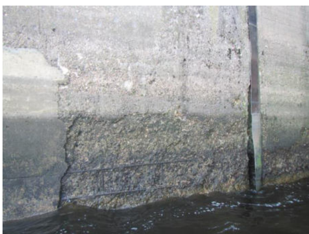
2. att. Virsmas izdrupumi, stierojuma atsegumi un korozija pie deformācijas šuves.
