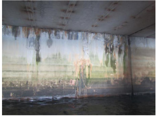
7. att. Filtrējoša plaisa spirālkameru sienā, izsāļojumi no sienas un pārseguma savienojuma.
