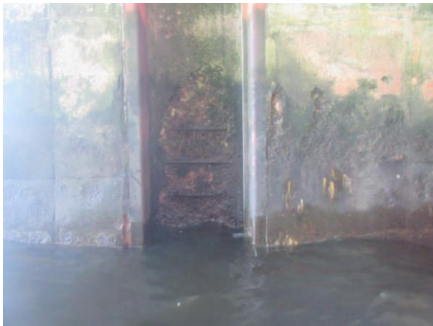
10. att. Virsmas izdrupumi, stiegrojuma atsegumi un korozija aizvaru rievā.
