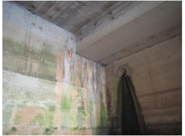
9. att. Izsāļojumi no konstrukciju savienojuma mezgla, nepilnīgs ūdens novadīšanas sistēmas izvada risinājums.
